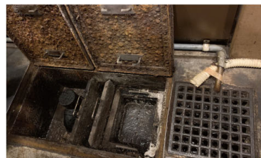
厨房の排水溝
