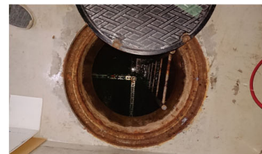
ビルの汚水槽
